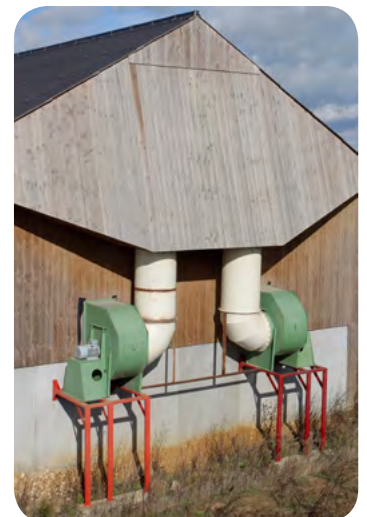
Ventilateurs de soufflage de l'air chaud
