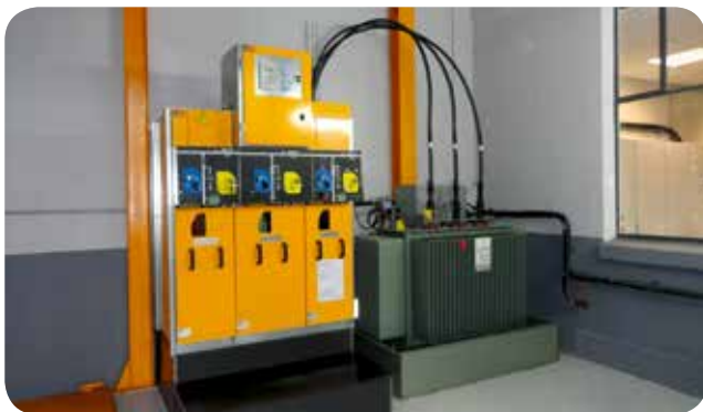
▷ Centrale de Ray-sur-Saône (70) : cellules HTA et transformateur
